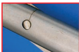
Fissura na região da junção de uma tesoura
