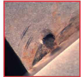
Delik korozyonu örneği
