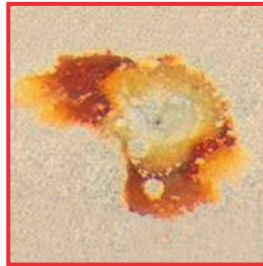
Delik korozyonu örneği
