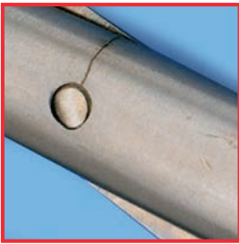
Bir makasın dişli bölgesindeki gerilme çatlakları
